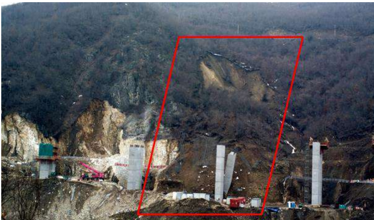
Foto 24: Shembja e dheut dhe dëmtimi i shtyllës gjatë ndërtimit të urës në Autostraadën “Arbën Xhaferi”
