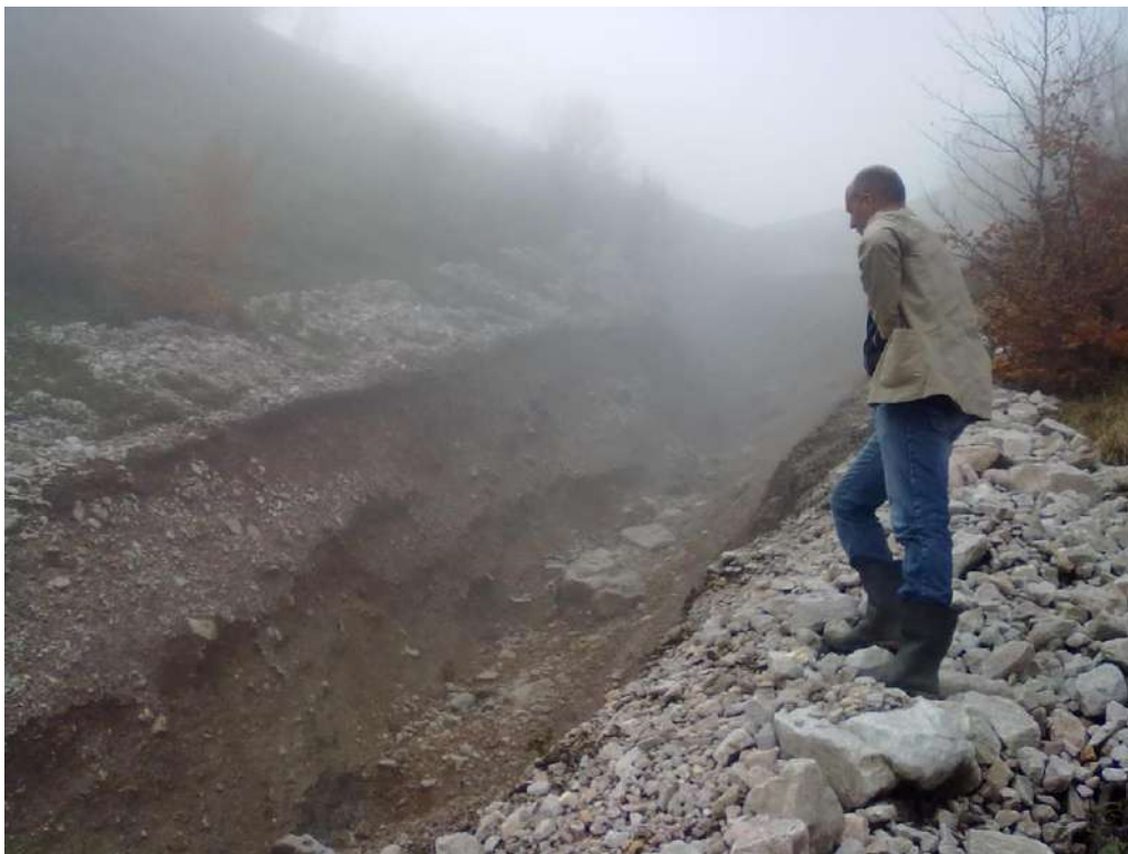
Foto 27: Erozioni te Reka e Kafexhisë
